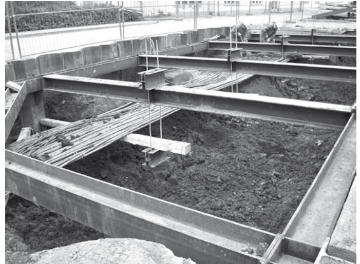
Gesichertes Kabelband im Bereich Teer- und Ammoniakgruben
