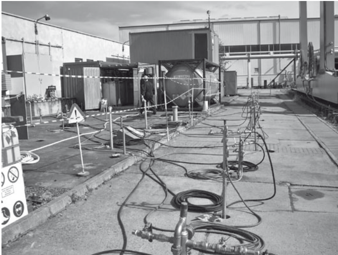
Für die ISCO-Sanierung wurden in den Bereichen Teer- und Ammoniakgruben und Scheibengasbehälter ca. 80 Infiltrations- und Überwachungsanlagen in den Untergrund in unterschiedlichen Tiefen eingebracht
